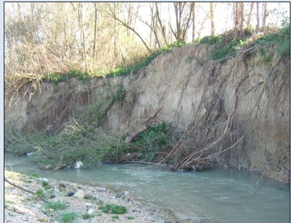
Erosione delle sponde
